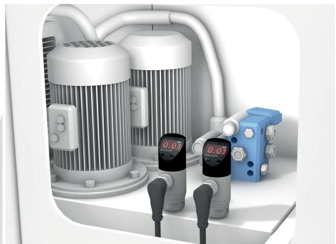
Messung der Drücke in einem hydraulischen Aggregat – z. B. einer Werkzeugmaschine – mit Hilfe zweier IO-Link-Drucksensoren
